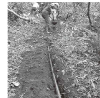
簡易水道施設
